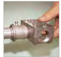
Conduit and connector with the joint sealing prepared to realize the IP54 connection on the multiple box correspondent. Electroducto y conector con las juntas de vedaciones preparadas para realizar la conexión IP54 en la caja multiple correspondiente.
